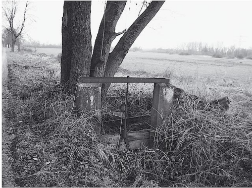
Stellfalle zur Aufstauung und Umleitung des Wassers
