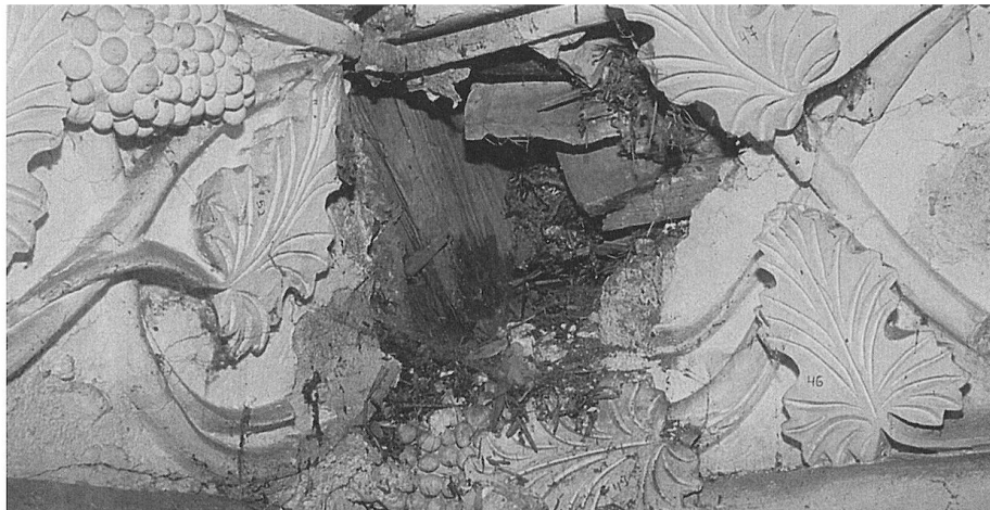
Gravierende Schäden in der Stuckdecke vor der Renovierung des Schlosses. Kreisarchiv Ravensburg, Aufnahme: Landesdenkmalamt Baden-Württemberg.
