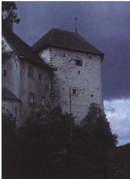
Wehrturm und Palas der Burg im Jahre 1968. Im Obergeschoss des Turmes befand sich ein 1834 eingebautes Gefängnisfenster. Der ruinöse Zustand der Wand des angrenzenden Palas ist zu erkennen.
